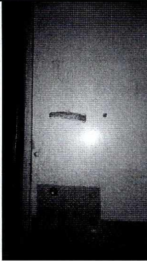
Fisura en puerta. (23/10/15 – 11:03 p.m)
