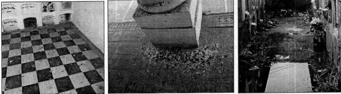
Foto No. 8 Deficiencia en actividades de limpieza en galerías y pabellones Cementerio Norte, Central y Sur.
