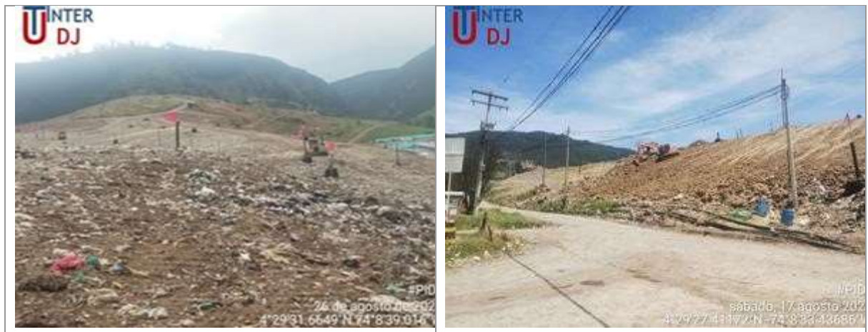
Foto No. 10-2. Instalación Métodos Ahuyentamiento Aves RSDJ Agosto 2024 Fuente: CGR Doña Juana / 2024.
